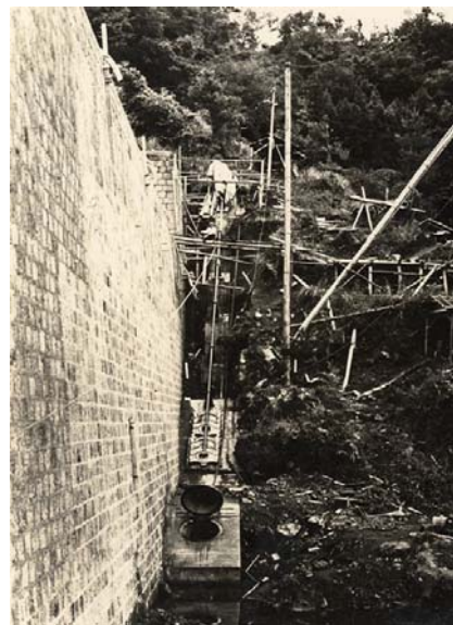
写真14 右岸側上流の取水設備
