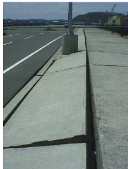
写真1 阿久根港岸壁の被害
