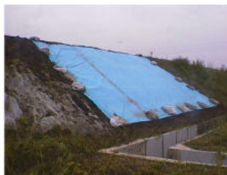
写真 2 加勢川右岸の堤防の崩壊
